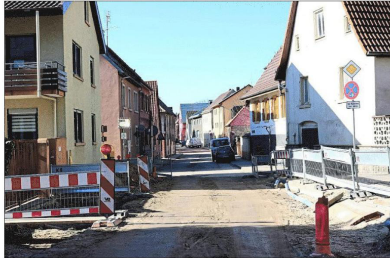
DIE ENGSTE STELLE der Jöhlinger Straße in Weingarten. Hier ist auch der Übergang vom ersten zum zweiten Bauabschnitt. Das Foto zeigt den Blick Richtung Ortsmitte. Foto: Lothar
