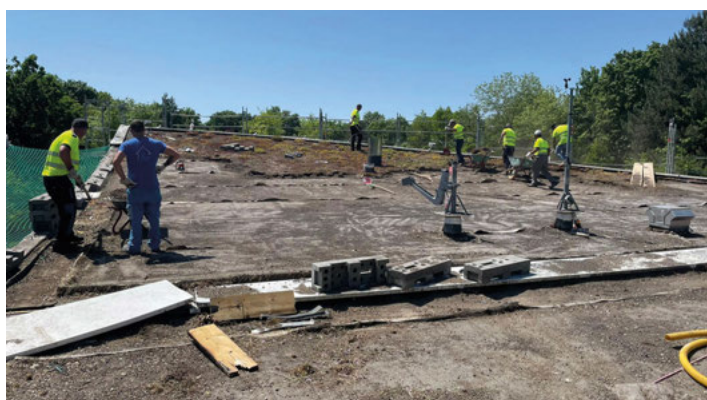
Arbeiter bei der Instandsetzung eines Flachdachs. Hier spricht man nicht über "Diskomfortstunden"
