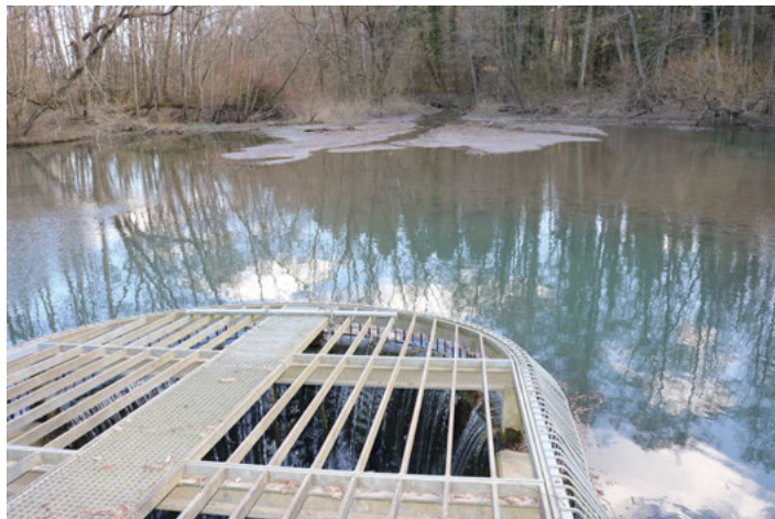
Das Einlassgitter des Schlossbergsees zum unterirdischen Durchlass
