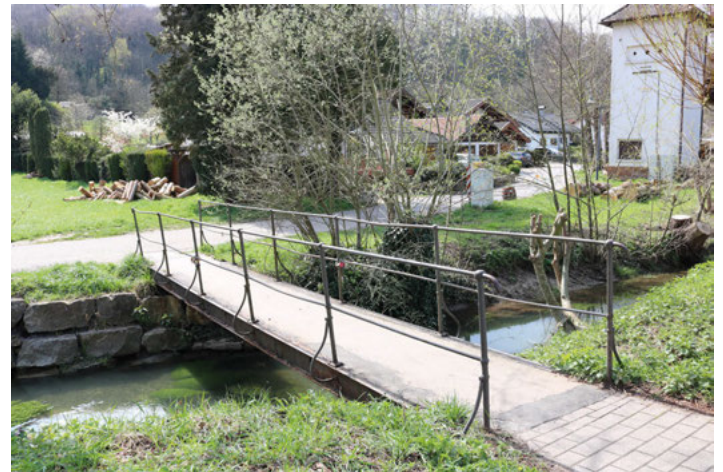
Die kleine Brücke über den Walzbach zwischen Schmalensteinweg und Heidengass soll abgebrochen werden. Eine Sanierung käme viel zu teuer.
