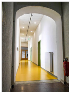
Übergang vom Eingangsbereich in den umgebauten Bereich, mit dem neuen sonnengelben Boden.
