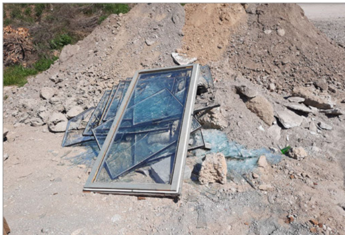
Fenster haben auf dem Materiallager nichts zu suchen
