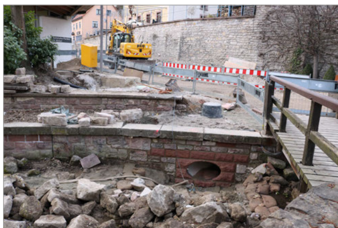
Der Auslass des Regenwasserentlastungskanal in den Walzbach wurde mit Sandstein verblendet und wird noch durch ein Gitter geschützt.
