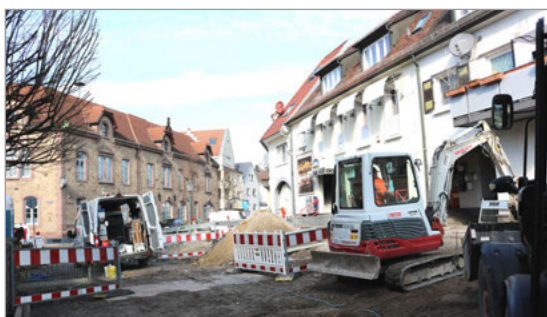
Die Arbeiten liegen im Zeitplan. Aktuell werden die letzten Hausanschlüsse für Trinkwasser gesetzt. Die Hauptleitung ist bereits verlegt.
