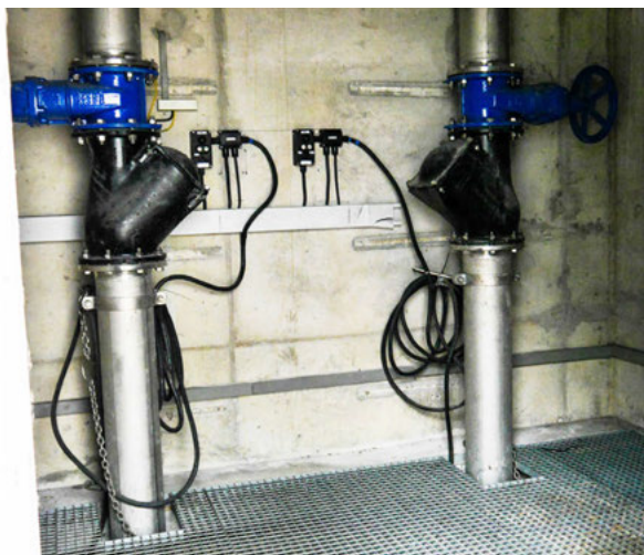
Auch die Pumpstation, die sich im Brückenbauwerk befindet, wurde auf Vordermann gebracht.
