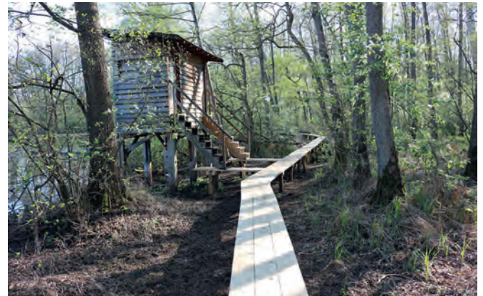
Auf kompletter Länge erneuert wurde der Steg im Weingartner Moor, der an einer Beobachtungshütte am See vorbei in eine grüne Wildnis führt.
