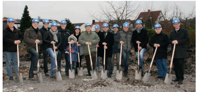
Spatenstich: von links nach rechts: Dieter Riekert-Möbus, Bernd Hauck (Tragwerksplanung), Thomas Becker, Torsten Hill (Planung und Projektleitung), Siegfried Polak, Marion Werner (Aufsichtsrätin), Klaus-Dieter Scholz, Thorsten Reinschmidt, Juan Baltrock (VB Stut-Weing), Günter Roth, Herald Sütsch, Michael Weikum (Aufsichtsratsvorsitzender), Willi Erkmann, Eric Bänziger (Bürgermeister)
