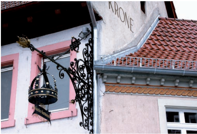
Das historische alte Wirtshausschild bleibt ebenso hängen wie auch das künstlerische Gesims beim Neuaufbau des Daches erhalten blieb.
